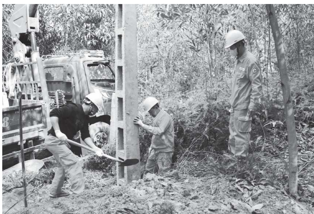
Công nhân Điện lực Phú Bình phối hợp với nhà thầu lắp đặt cột để cấp điện cho các hộ dân ở xóm Thông Bong, xã Tân Kim.
